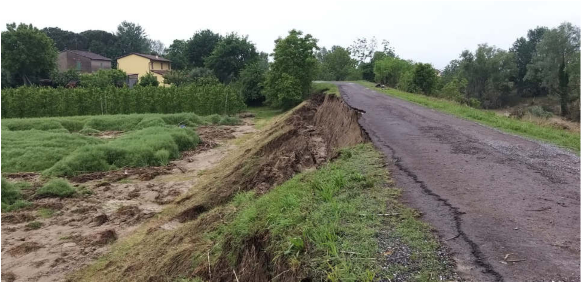
Erosione spondale degli argini del Lamone
