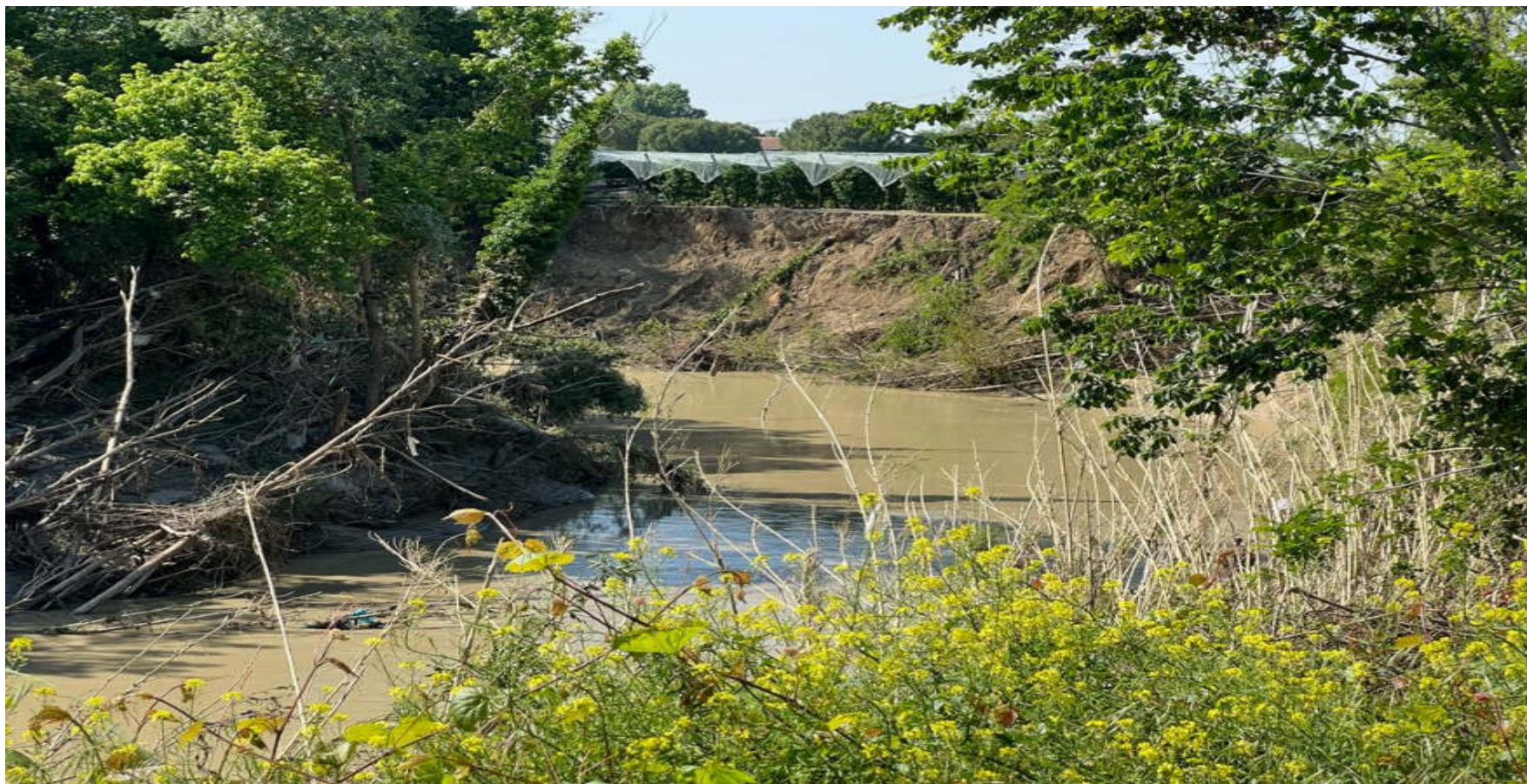
Erosioni spondali lungo gli argini del fiume Savio in loc. Matellica (Ravenna)
