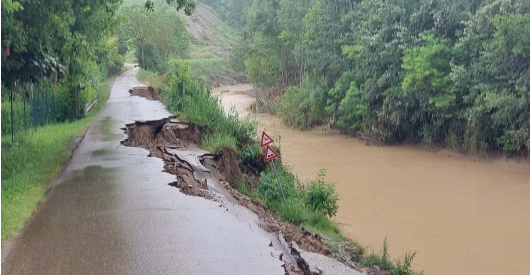
Erosioni spondali lungo gli argini del fiume Lamone (comune di Faenza)
